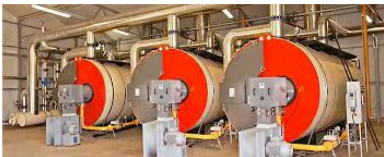
Figura. Caldera de GLP
