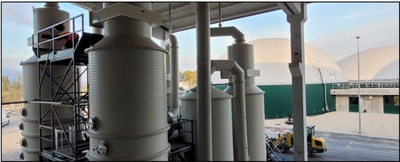
Figura. Sistema de recuperación de nitrógeno
