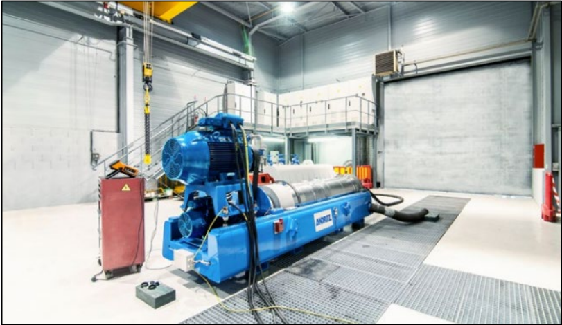
Figura. Sistema de centrífuga de separación sólido-líquido. Fuente: Virtus.
