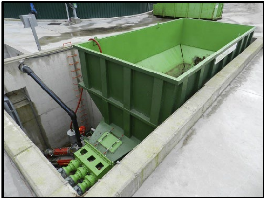
Figura. Tolva de recepción con tornillos de extracción.
